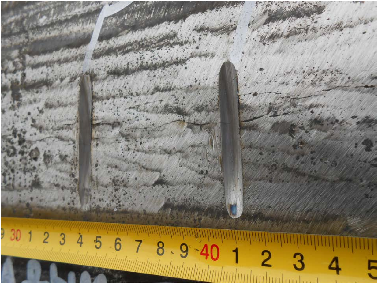
Рис.20 Стресс-коррозионные дефекты, обнаруженные при переизоляции участка газопровода «Ямбург-Елец I»
