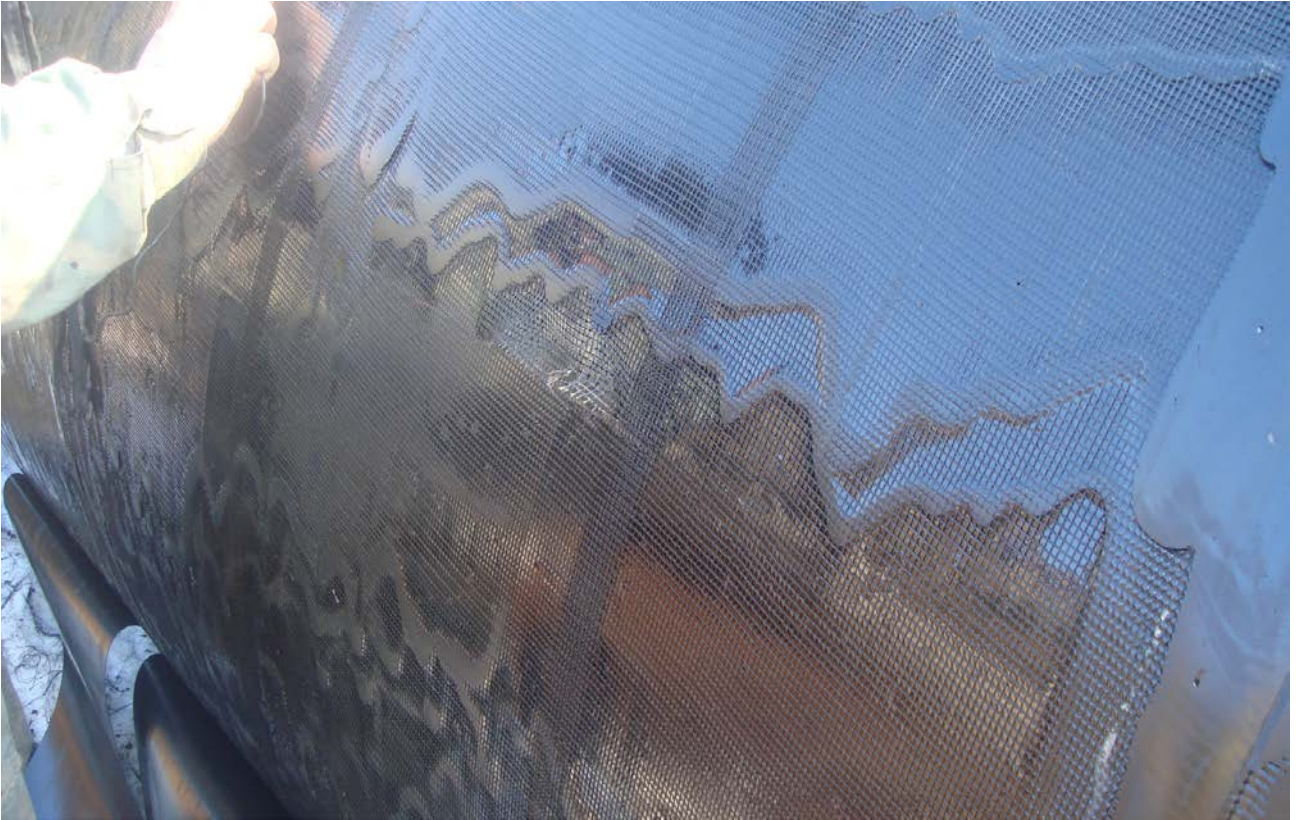
Рис.60 Некачественное нанесение защитного покрытия
