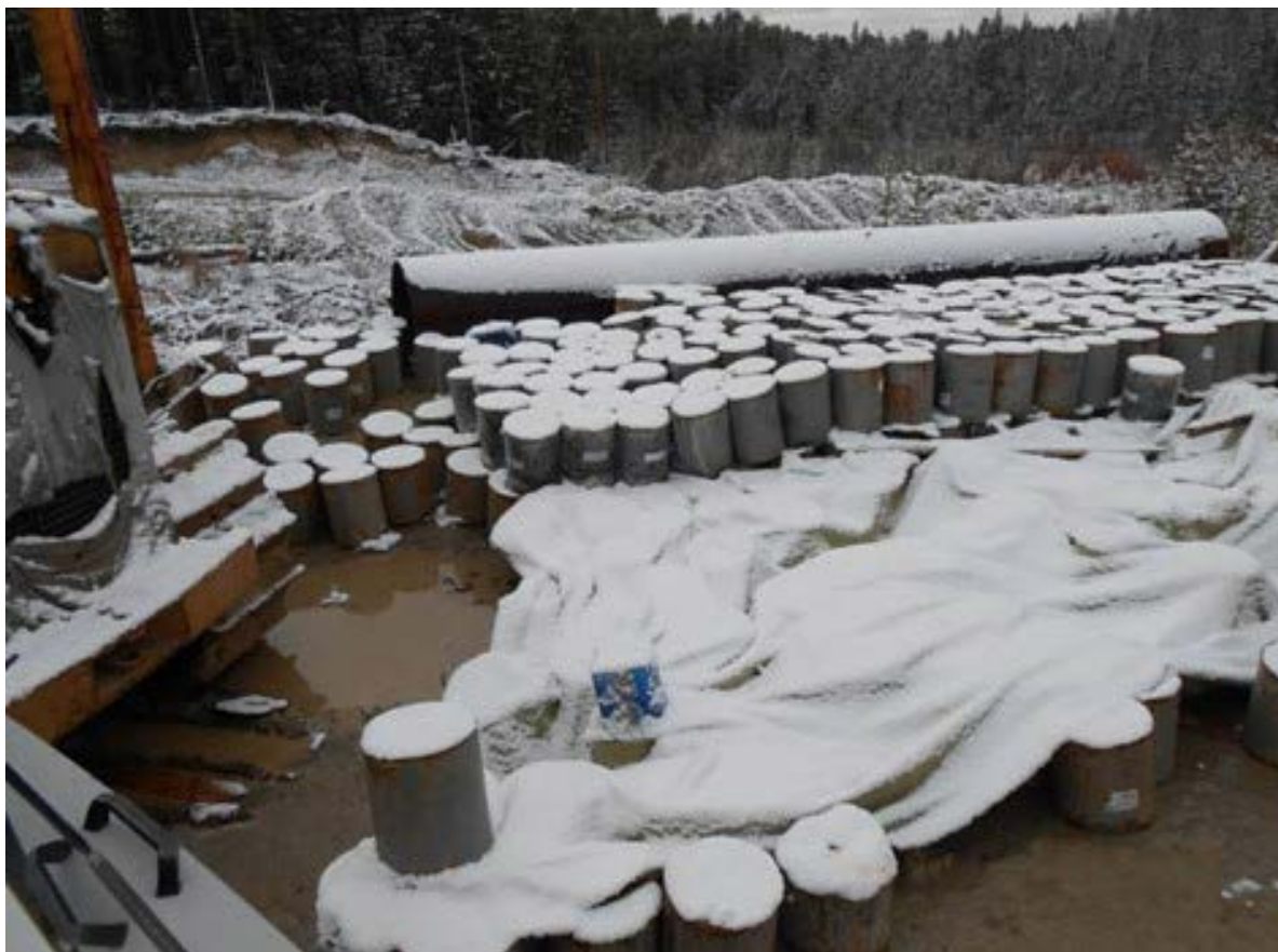
Рис.7 Нарушения правил хранения изоляционных материалов
