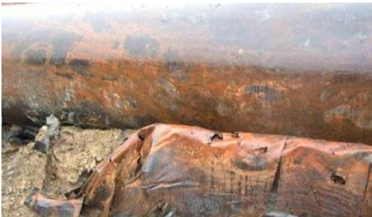
Рис.16 Коррозионные дефекты, селективная коррозия
