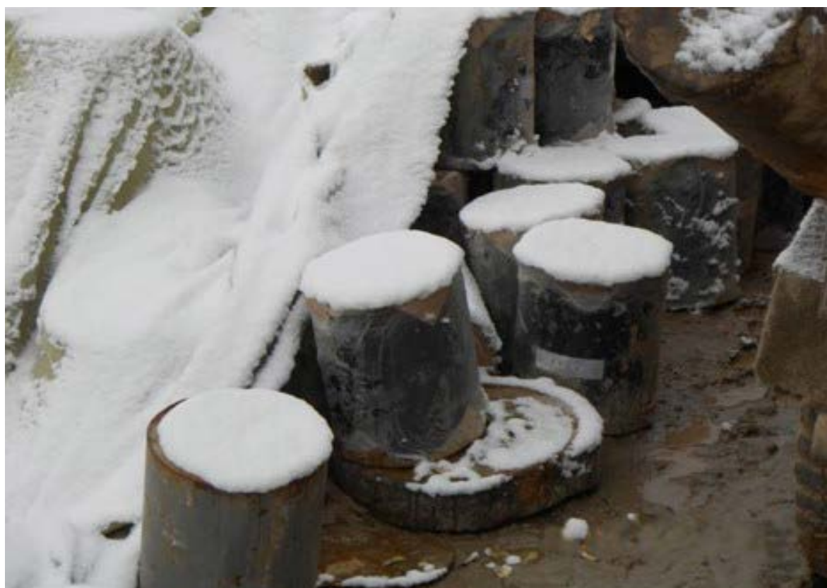
Рис.8 Нарушения правил хранения изоляционных материалов
