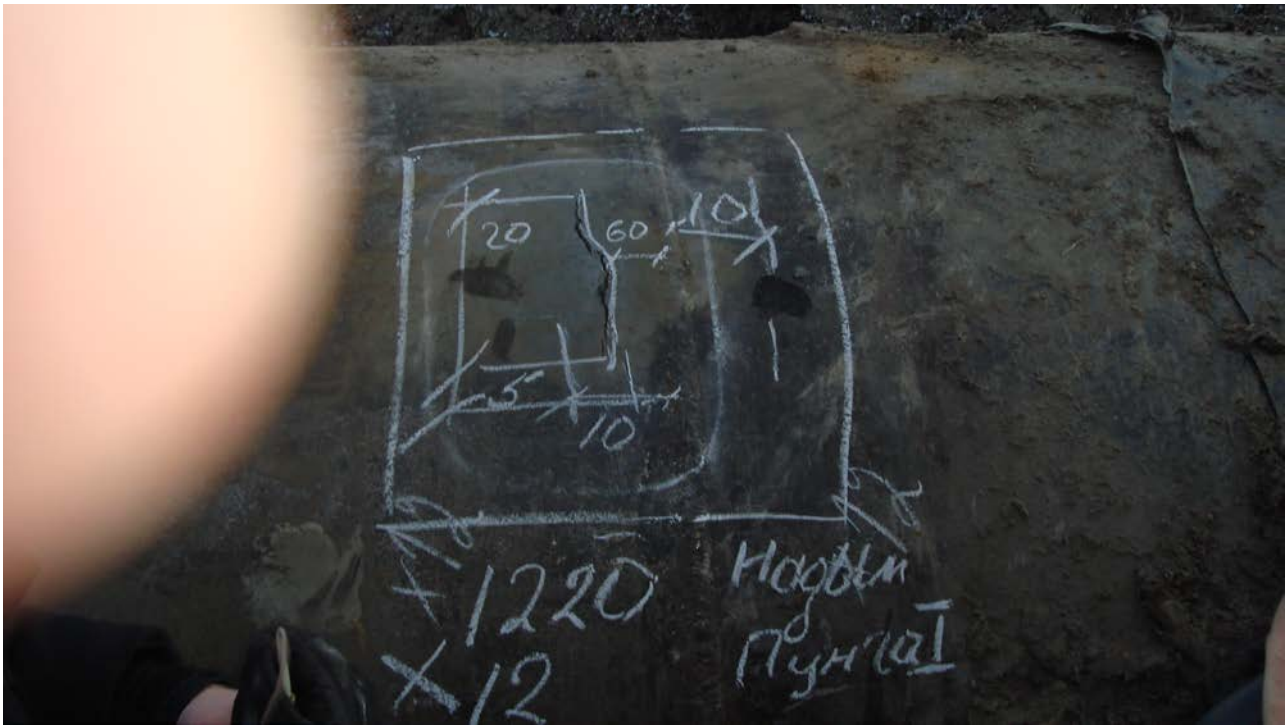
Рис.18 Стресс-коррозионные дефекты, обнаруженные при переизоляции участка газопровода «Надым-Пунга»
