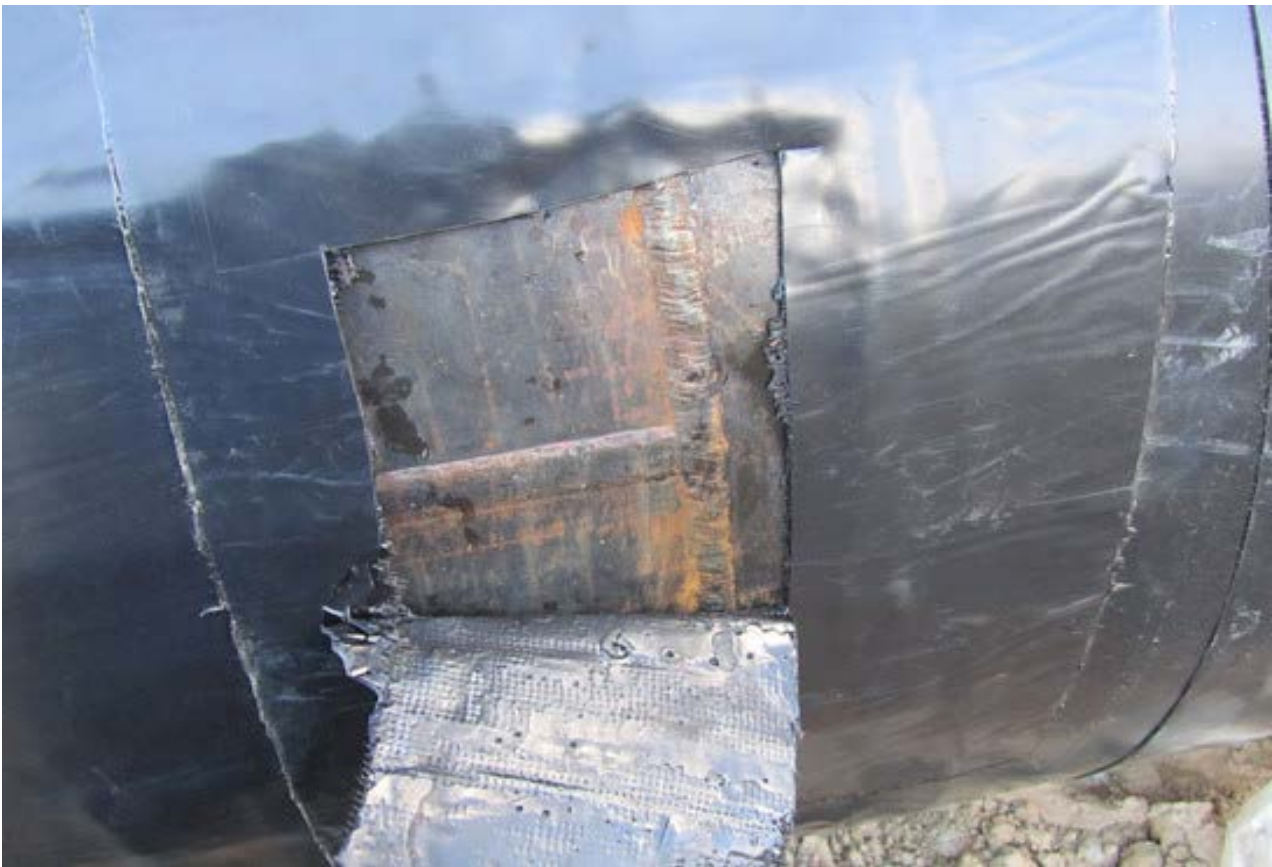
Рис.41 Отсутствие грунтовки на поверхности трубы ЗП «АРМАС»
