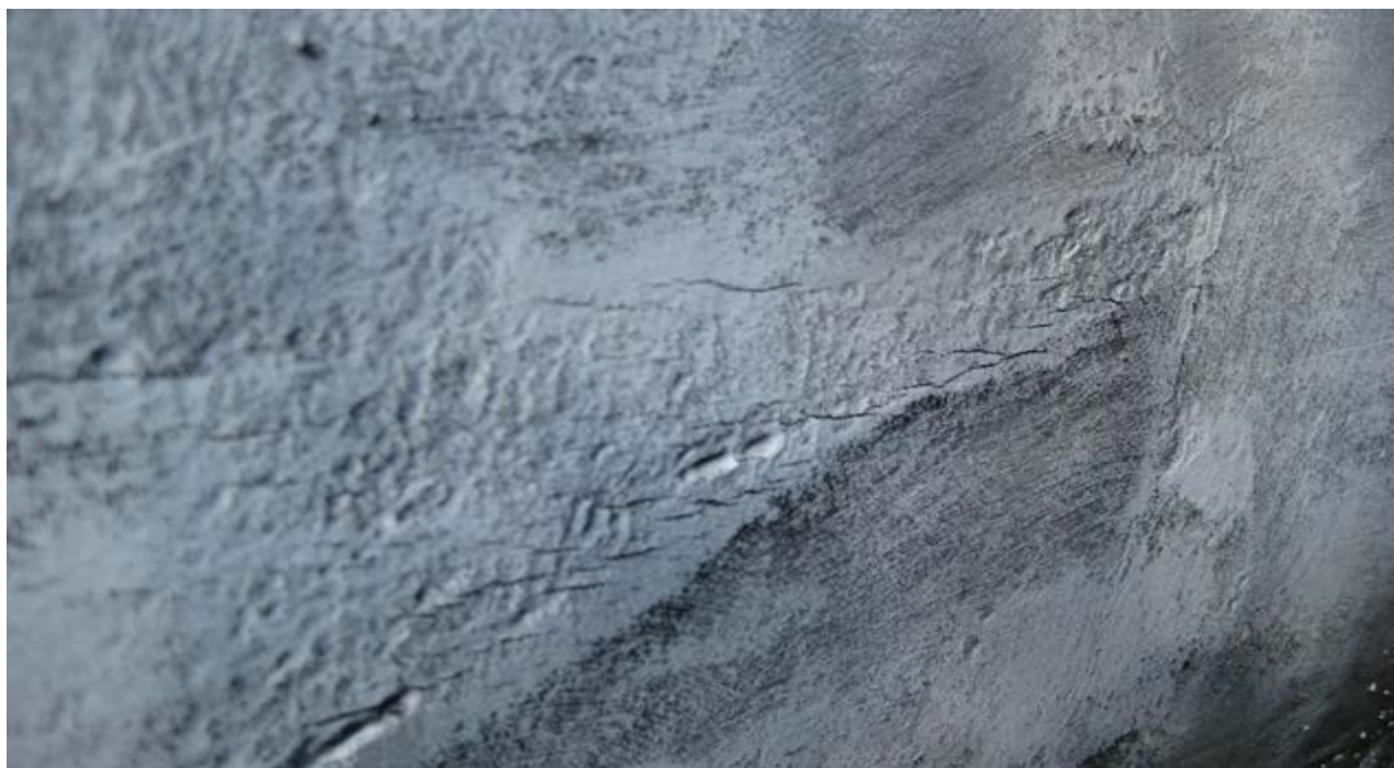
Рис.24 Стресс-коррозионные дефекты, с элементами язвенной коррозии
