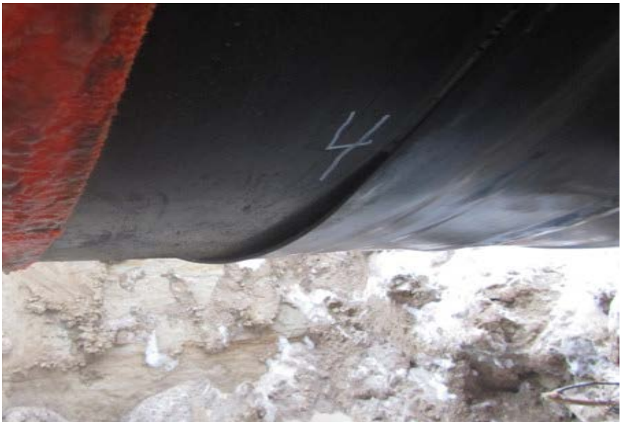
Рис.43 Брак при нанесении ТУМ Отслоение изоляции
