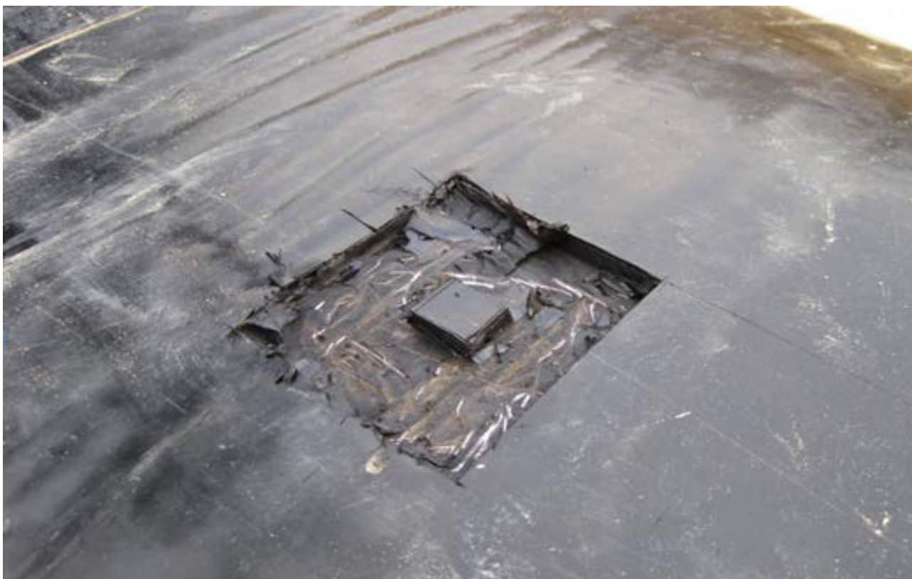
Рис.29 Отрыв защитного покрытия «РАМ» до металла
