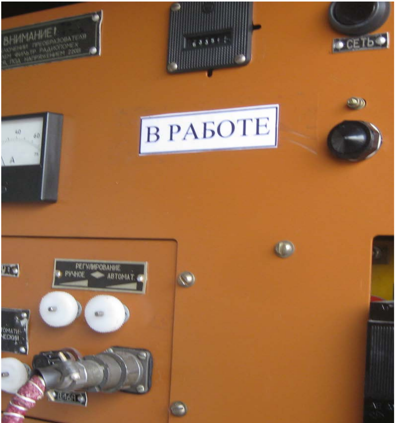
Рис.10 Станция катодной защиты «ТДЕ-9»
