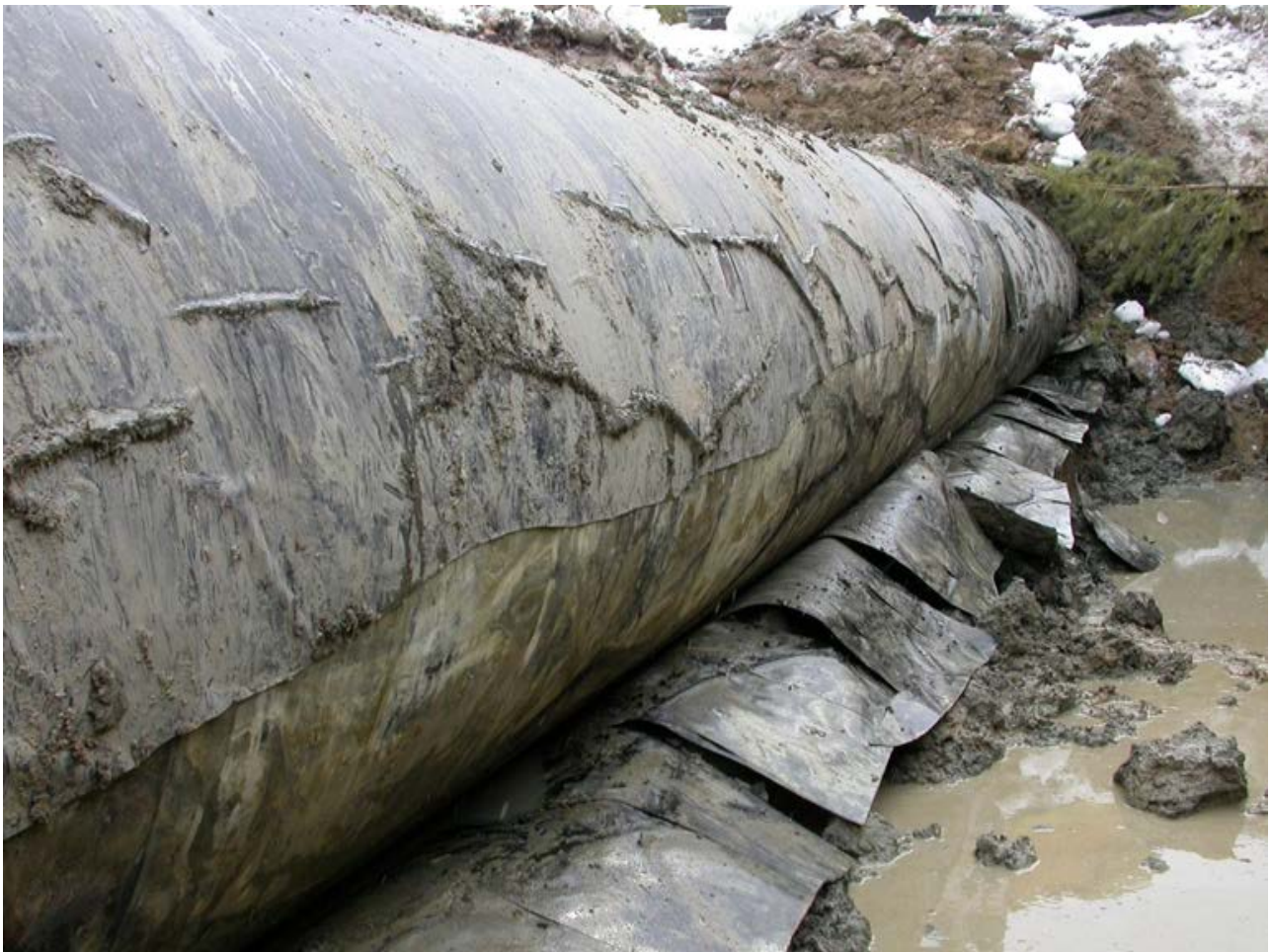
Рис.6 Состояние защитных покрытий участков МГ назначенных к переизоляции
