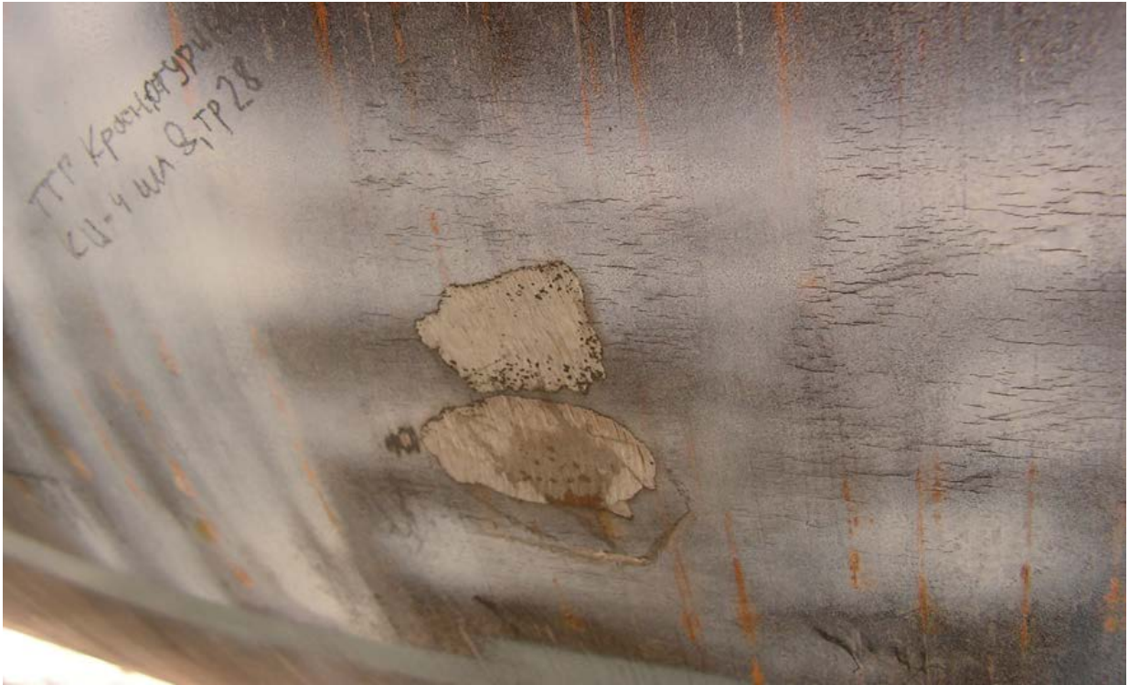
Рис.14 Стресс-коррозионные дефекты, обнаруженные при переизоляции участка газопровода «Ямбург-Елец 1» км. 855-860
