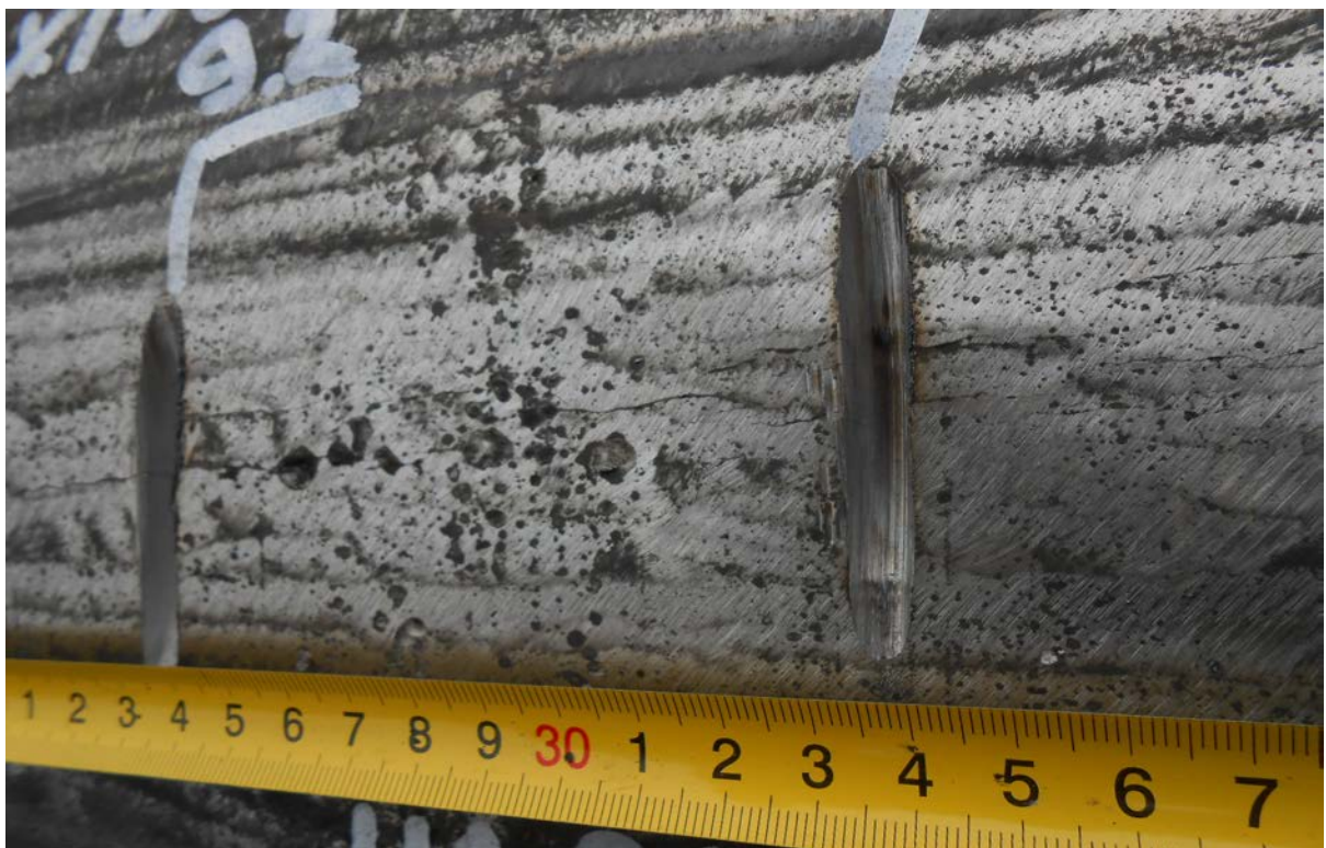
Рис.21 Стресс-коррозионные дефекты, обнаруженные при переизоляции участка газопровода «Ямбург-Елец II»
