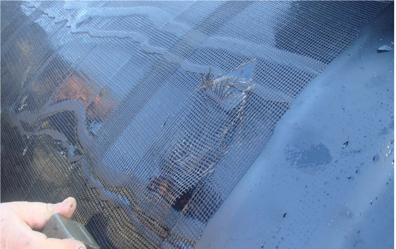
Рис.58 Некачественное нанесение защитного покрытия
