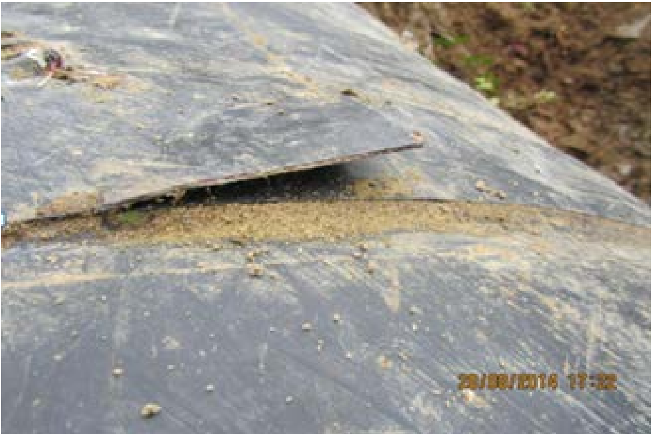
Рис.48 Отслоения замковой пластины
