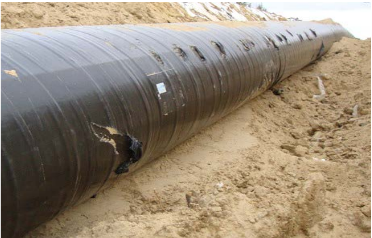
Рис.45 Повреждения ЗП «РАМ», нанесенные при укладке газопровода
