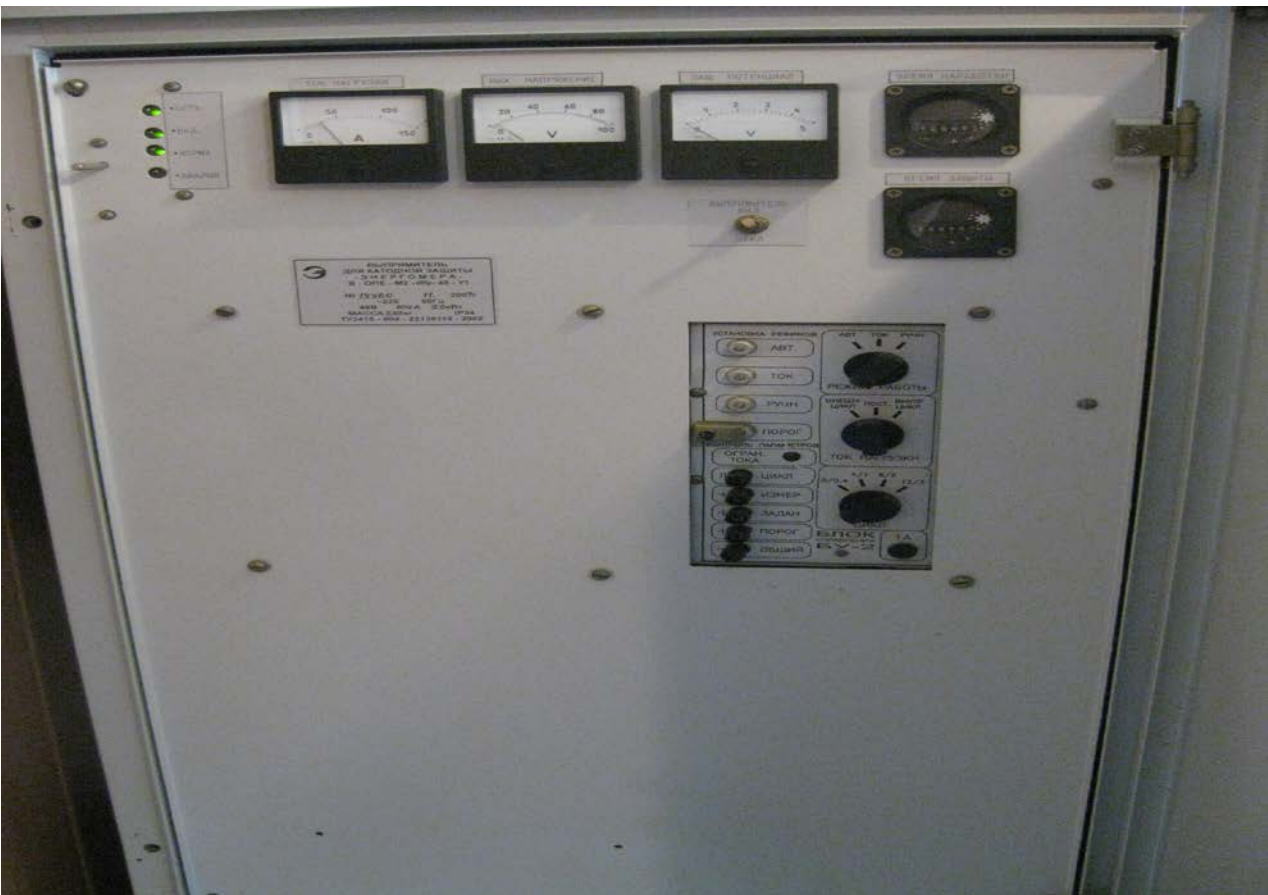
Рис.12 Станция катодной защиты «ОПЕ»
