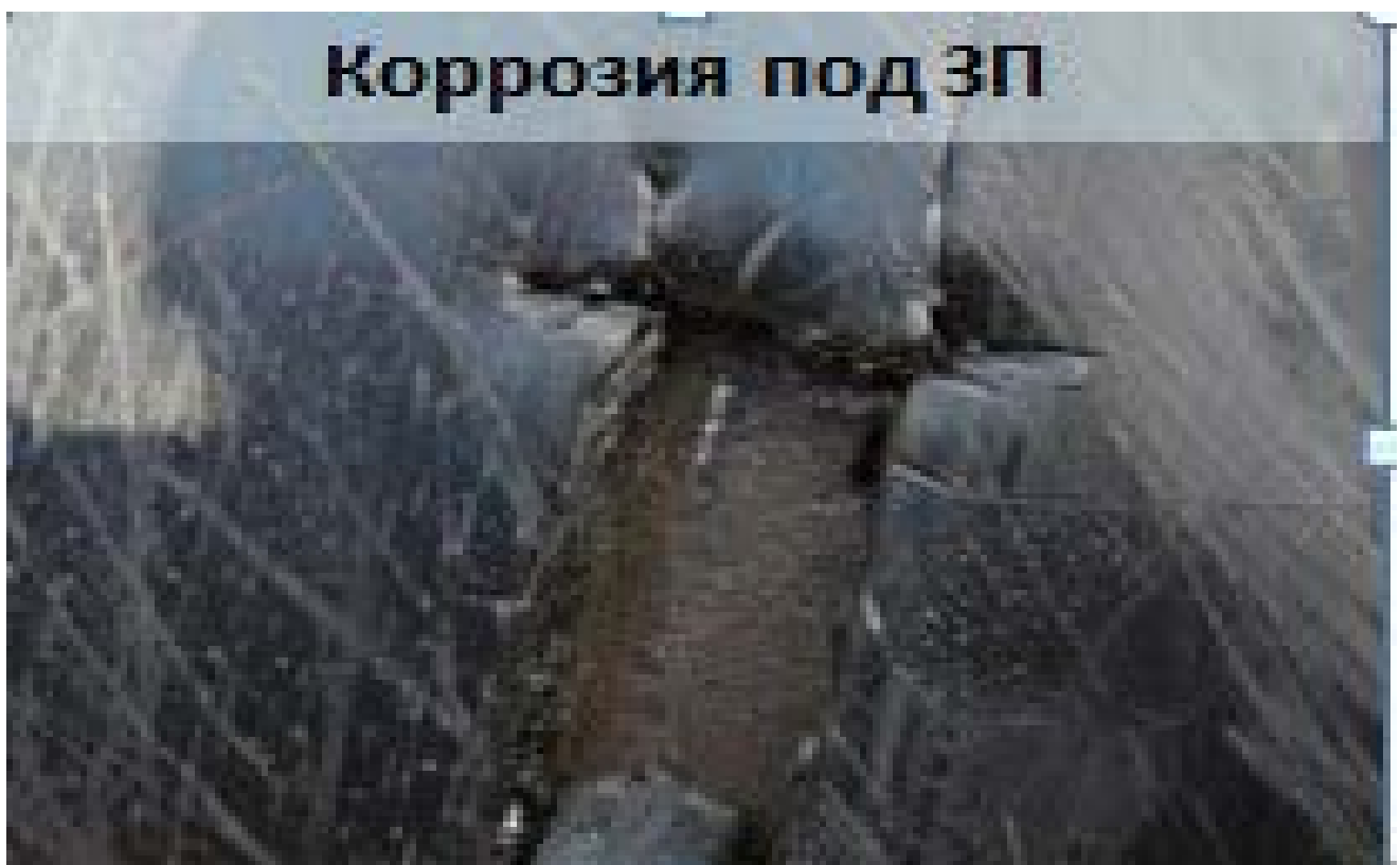
Рис.66 Коррозия под защитным покрытием
