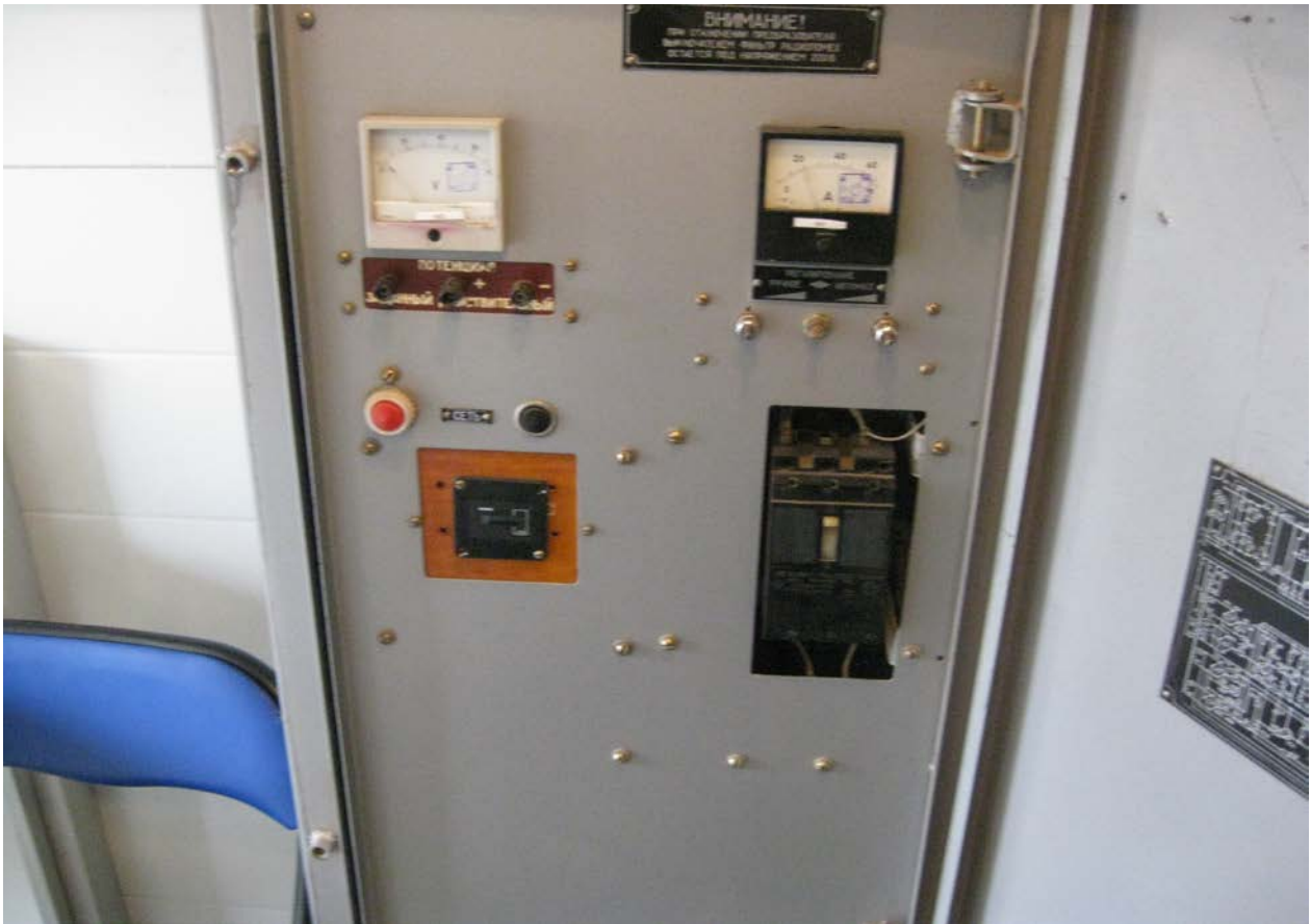
Рис.8 Станция катодной защиты «ПАСК»
