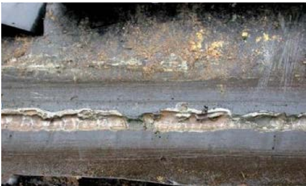
Рис.17 Коррозионные дефекты, язвенная коррозия
