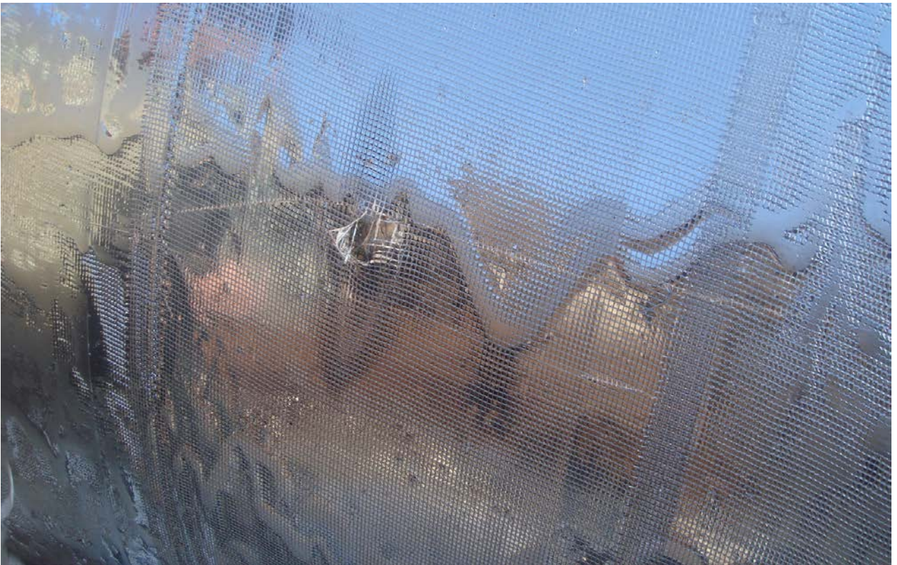
Рис.59 Некачественное нанесение защитного покрытия
