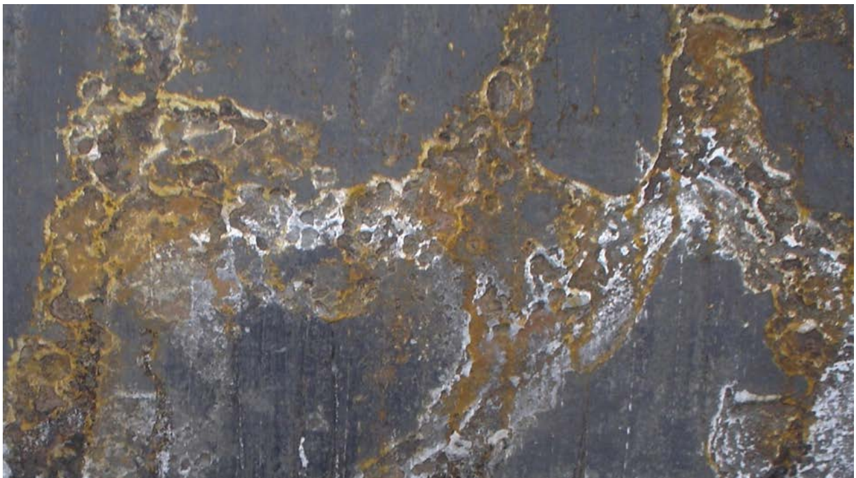
Рис.15 Коррозионные дефекты, язвенная коррозия обнаруженные при переизоляции участка газопровода «Ямбург-Елец 1» км. 855-860
