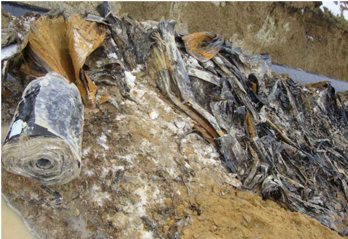
Рис.9 Нарушения по утилизации строительного мусора
