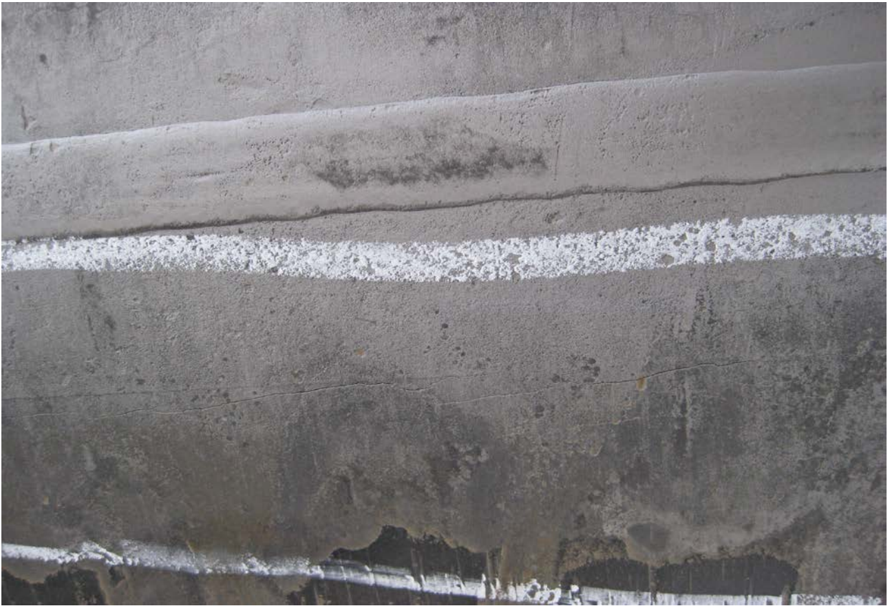
Рис.22 Стресс-коррозионные дефекты, обнаруженные при переизоляции участка газопровода «Центр II»
