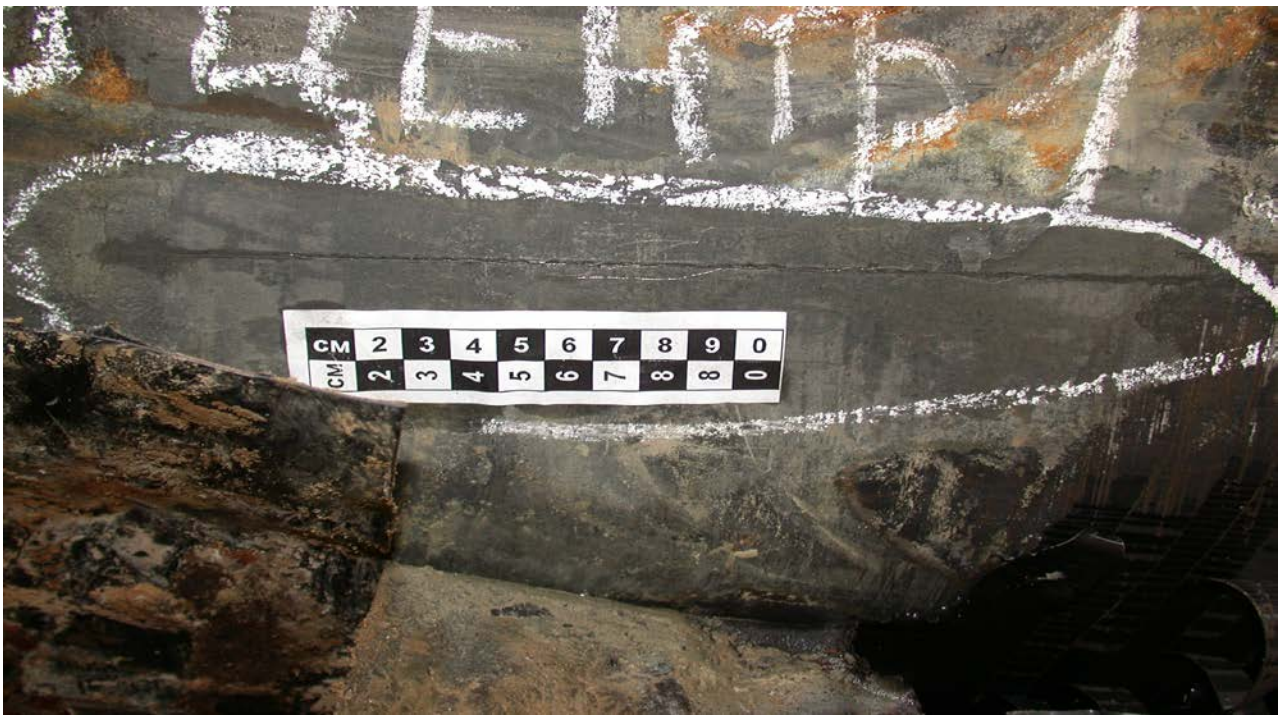
Рис.23 Стресс-коррозионные дефекты, обнаруженные при переизоляции участка газопровода «Центр I»
