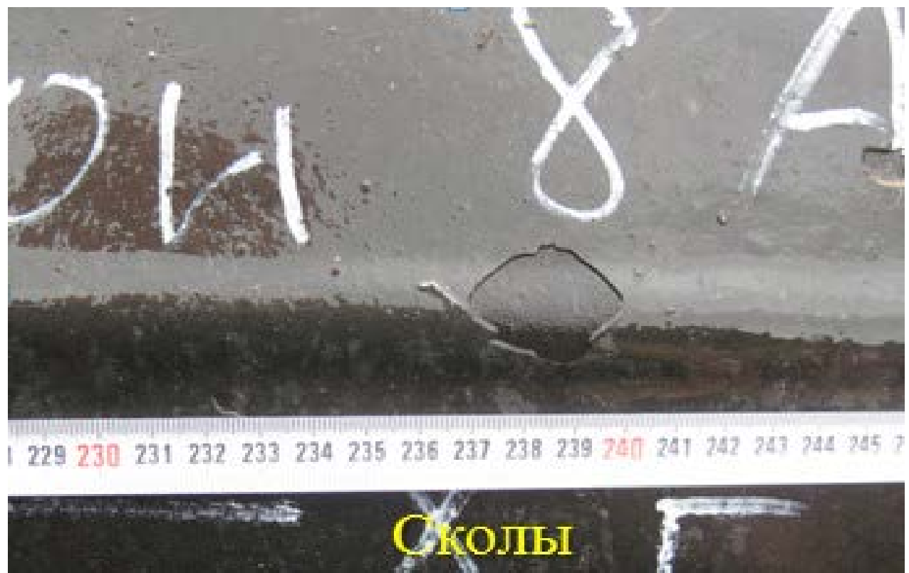
Рис.51 Сколы на теле трубы
