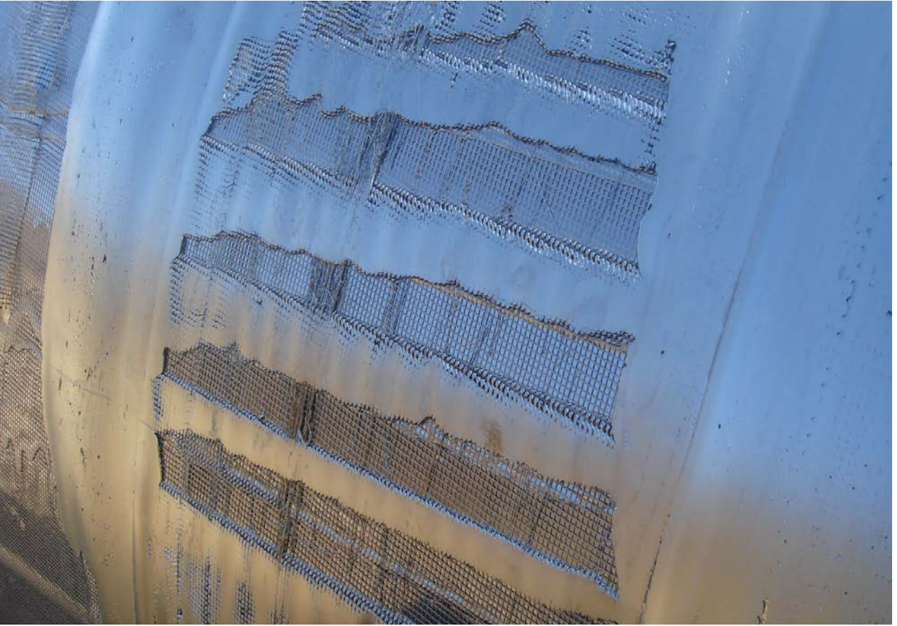
Рис.56 Некачественное нанесение защитного покрытия
