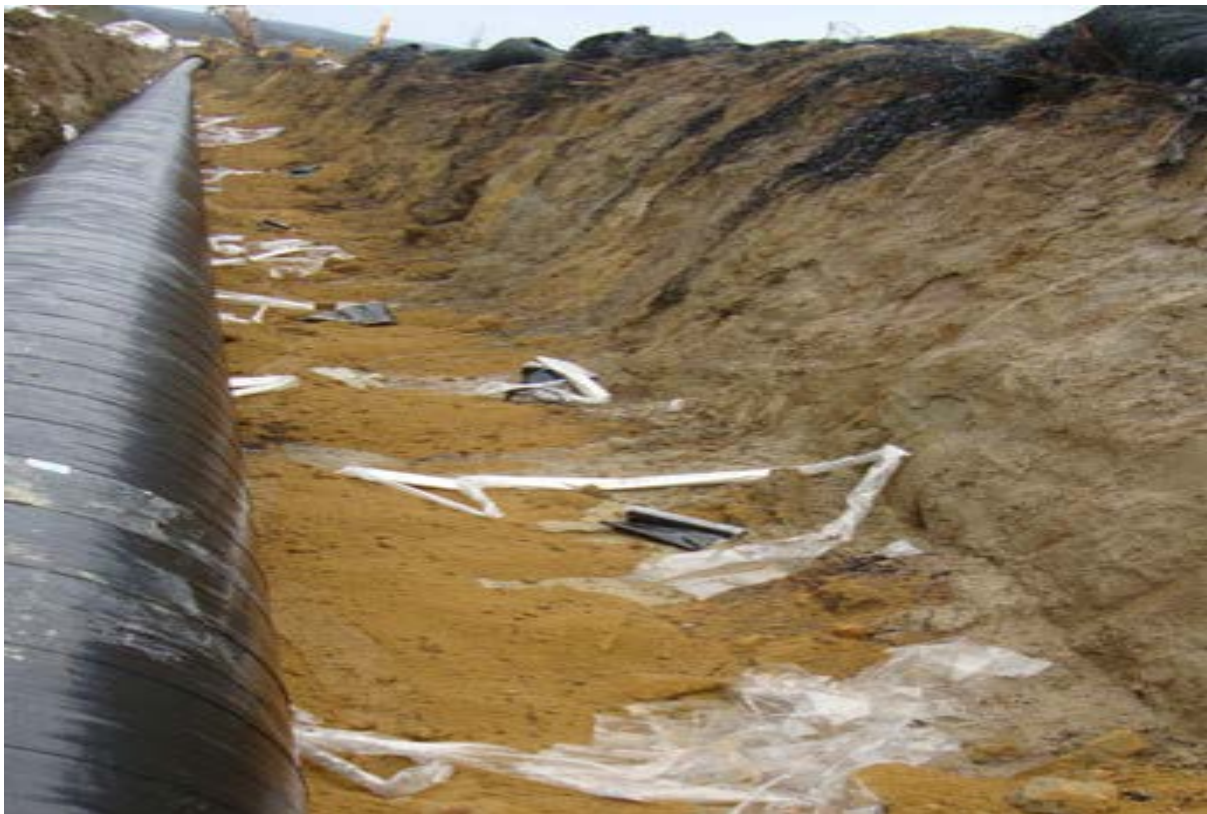
Рис.10 Нарушения по утилизации строительного мусора
