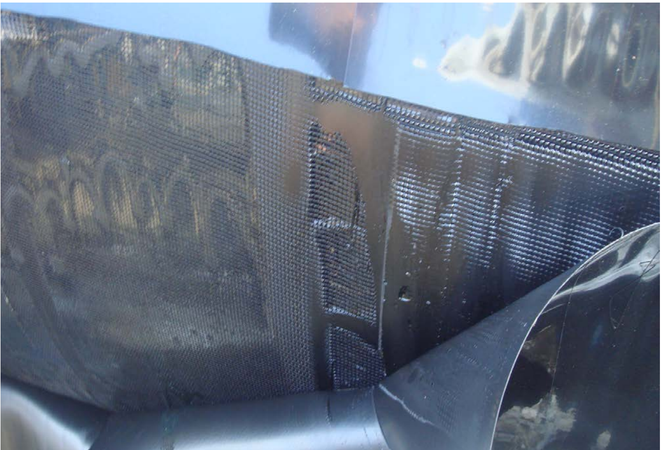
Рис.63 Некачественное нанесение защитного покрытия
