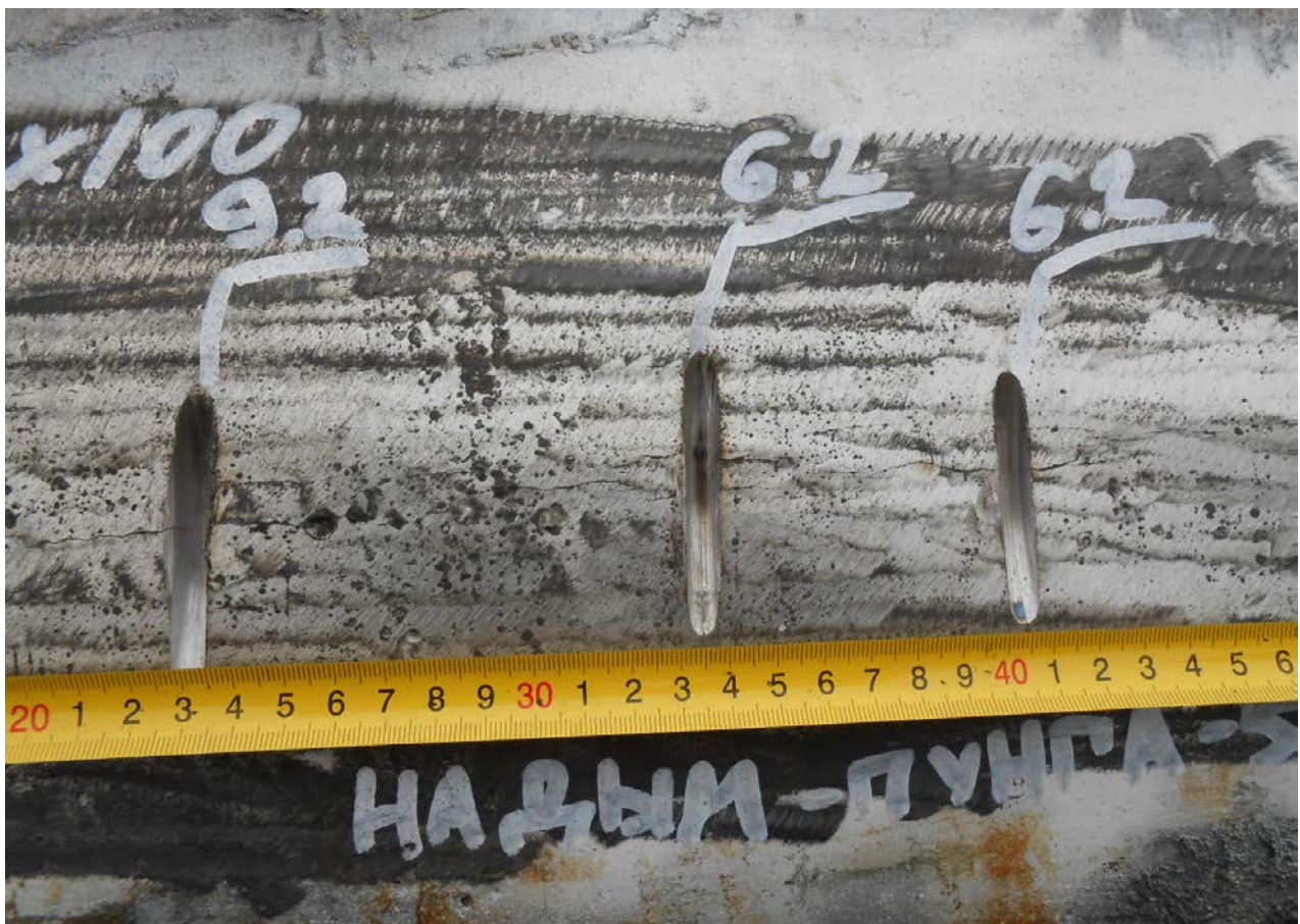
Рис.19 Стресс-коррозионные дефекты, обнаруженные при переизоляции участка газопровода «Надым-Пунга»
